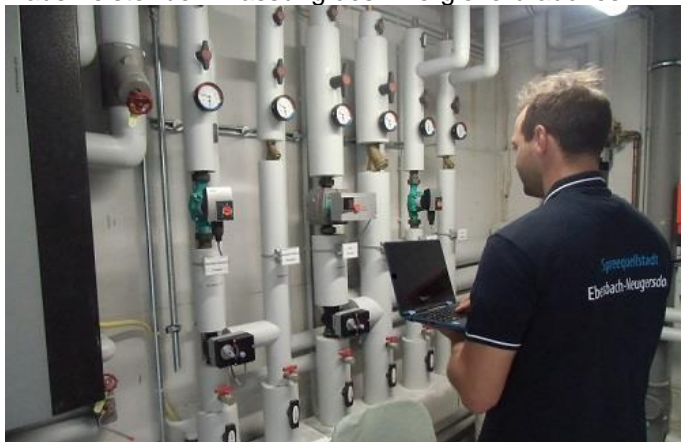
Hausmeister bei Erfassung des Energieverbrauches
